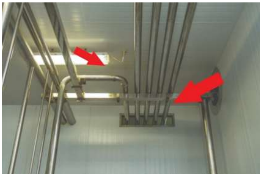
Foto 3 - Dutos que levam os miúdos da sala de corte para o setor de miúdos através de sucção
