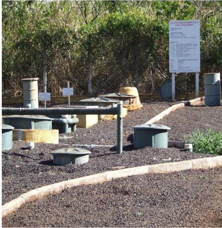
Figura 16 Estação de Tratamento de Esgoto – ETE.
