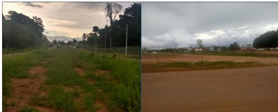
Figura 8: Avenida de Sinop sem calçamento viário
