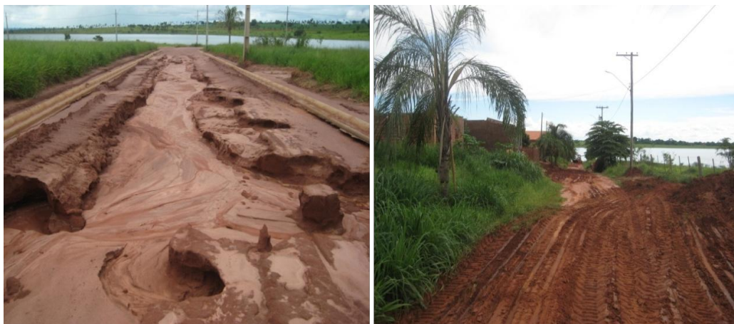
FOTO 9: Erosão em loteamentos
