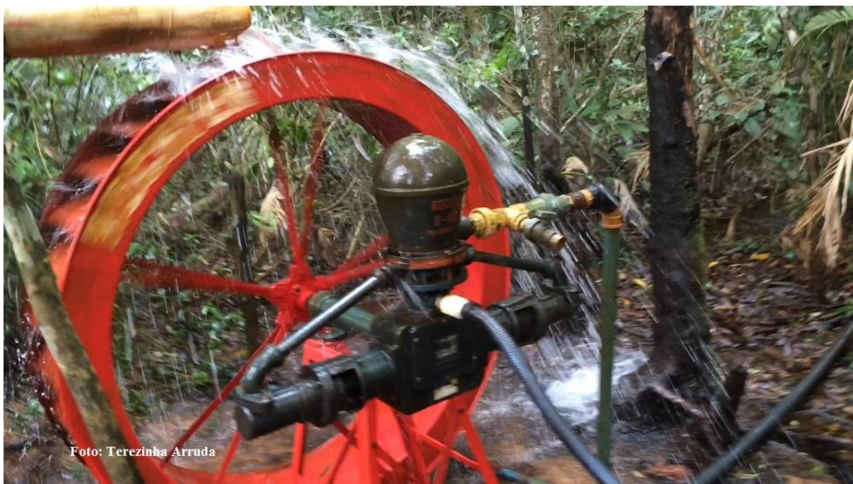
Figura 34 – Roda d'água que bombeia a água do Córrego do Quilombo para o reservatório 2
