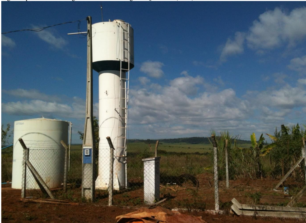
Figura 32 – Primeiro reservatório de 12 mil litros para armazenar água oriunda do poço artesiano (2012) e o segundo para armazenar água oriunda do Córrego do Quilombo (2016) no PDS Santa Helena
