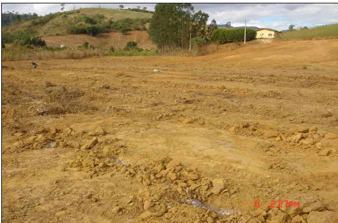
Figura 47 - Solo compactado na área do projeto piloto de revegetação no Distrito de São Dalmácio, município de São Roque do Canaã, ES
