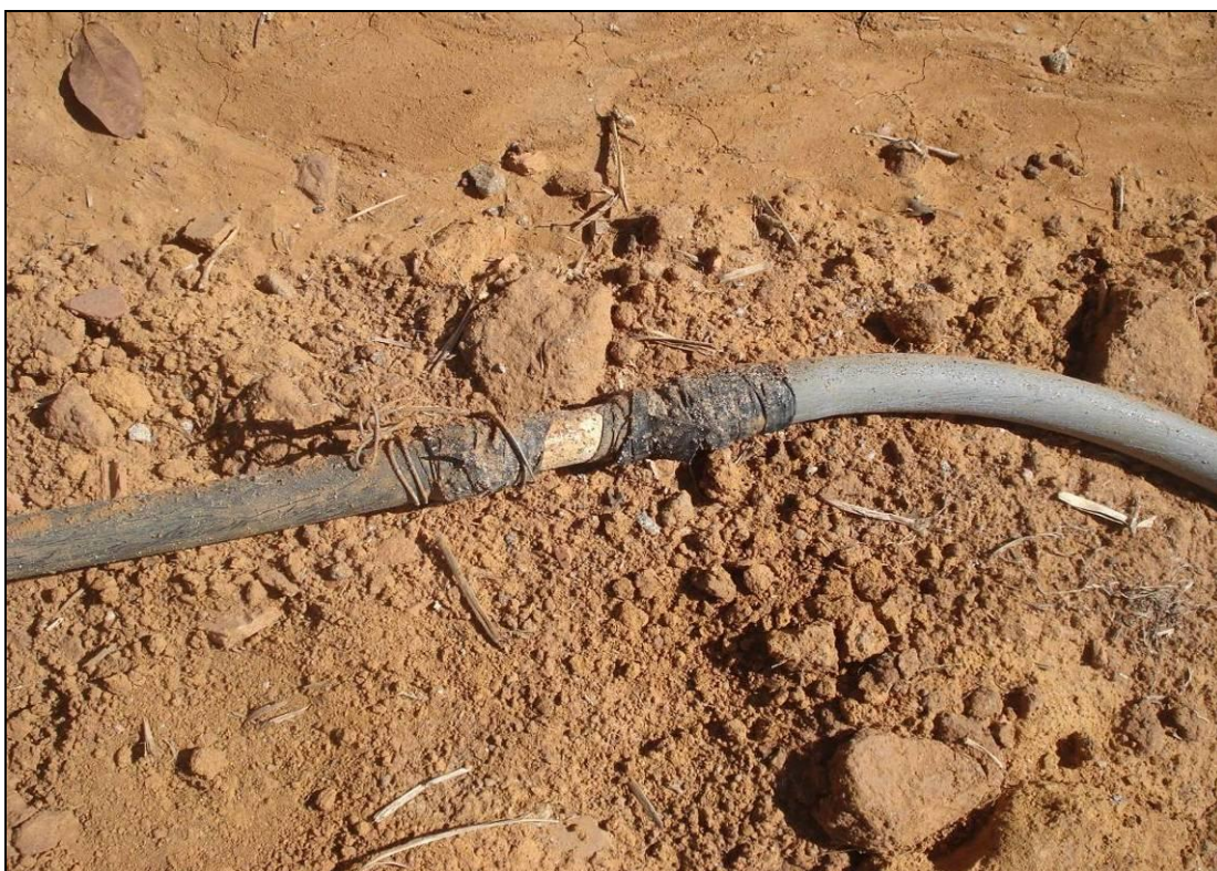
Figura 61 - Emenda da mangueira com câmara de ar e arame recozido, para evitar o rompimento e vazamento de água, no projeto piloto no Distrito de São Dalmácio, município de São Roque do Canaã, ES
