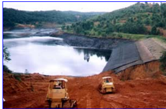
FOTO 08 : DETALHE DA BARRAGEM ROMPIDA FONTE : SOS RIO POMBA
