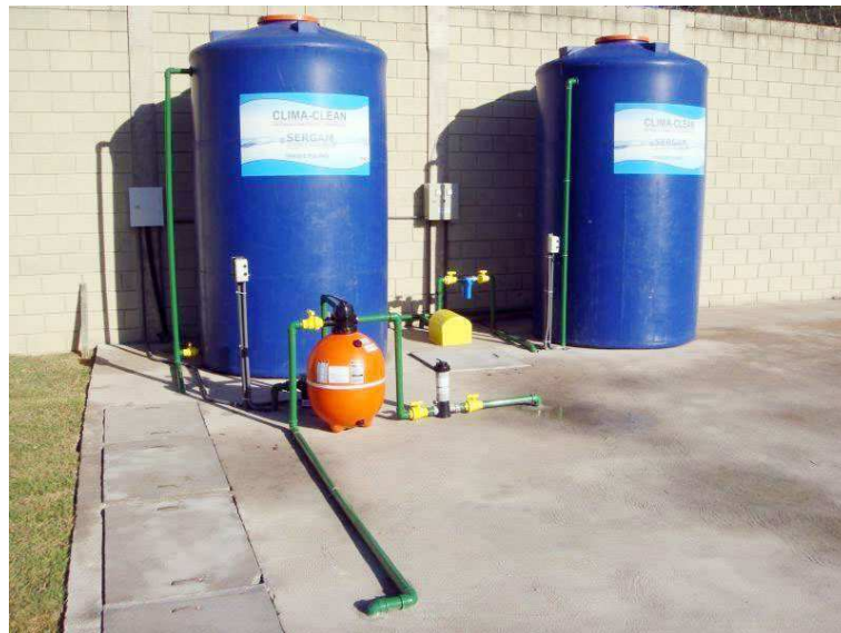
Figura 4 – Armazenamento de água para reuso.
