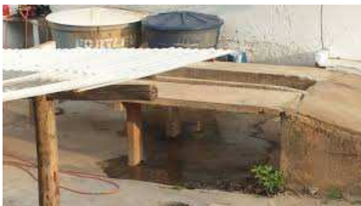
Figura 19 – Desperdício de água vazando de caixa em Lava-Jato.
