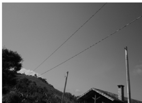
Figura 25 – Quilombo Pilões. Sistema de energia elétrica que passa no meio dos postes já instalados de luz para atender à comunidade, porém que não fornece energia para a população, apenas para proprietários particulares.
