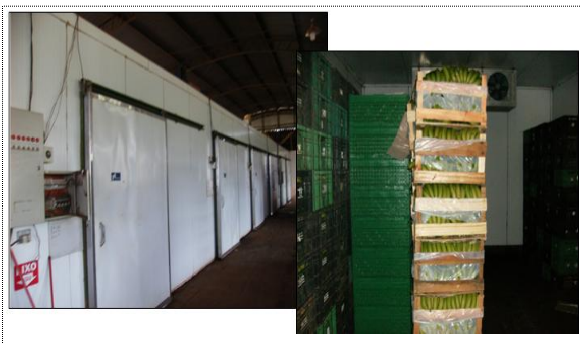
Figura 33 - Estrutura utilizada para climatização de Bananas
