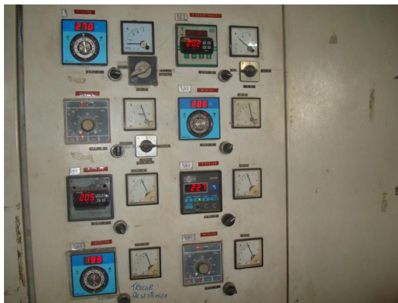
Figura 4.17 – Painel de controle da temperatura do engate da rosca, do filtro, do pescoço e da matriz
