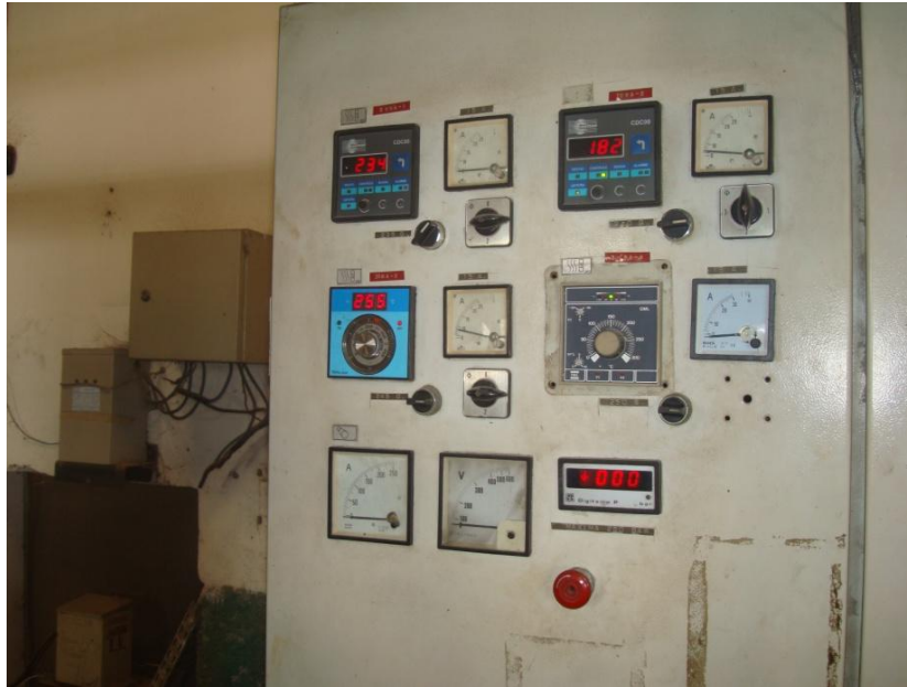
Figura 4.13 – Painel de controle da temperatura das zonas do canhão
