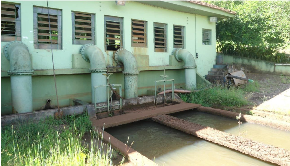
Figura 4 – Estação de Tratamento de Água
