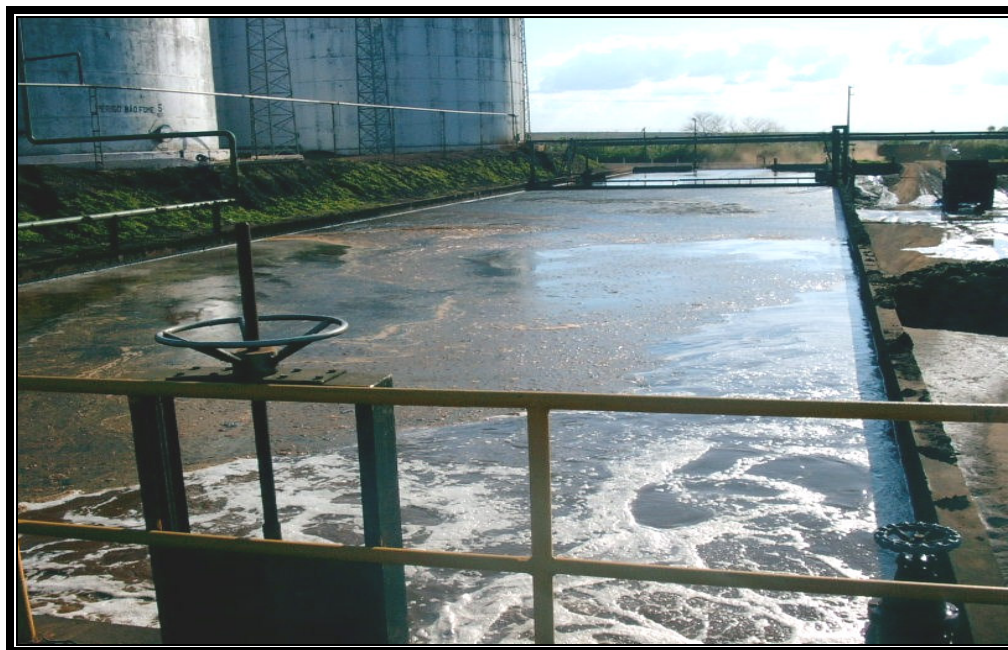
Figura 12 - Tanque de sedimentação para tratamento da água de lavagem de cana
